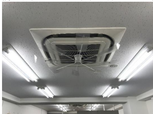
【空調の効率化ファン 3 機、照明 LED 化：省エネ】
